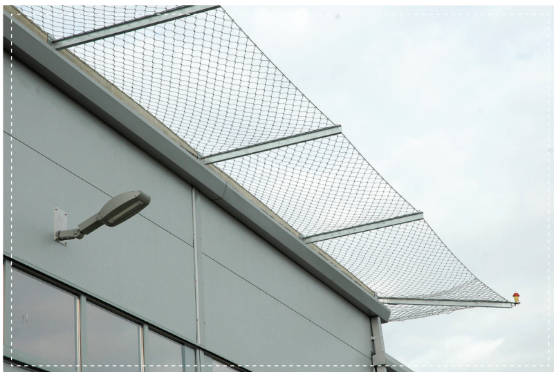
Siatka jako zabezpieczenie lądowiska helikopterów
