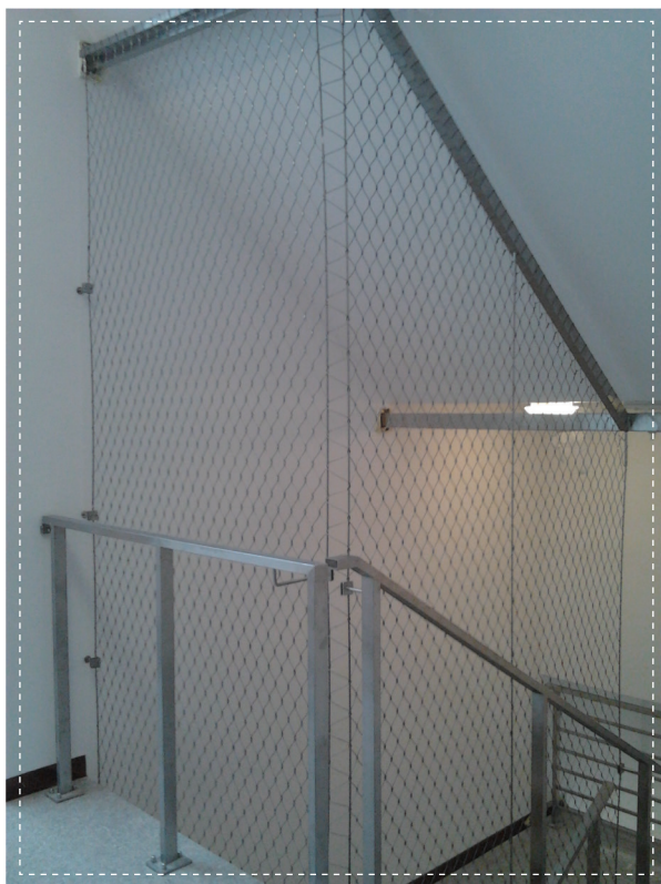
Zabezpieczenie na klatce schodowej - siatka rozpięta na linach konturowych
